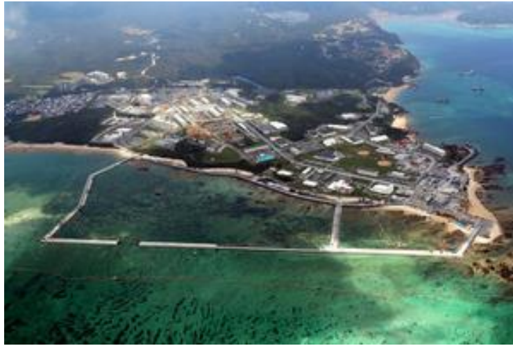
2018年7月26日 埋立工事が進み、辺野古の海岸の一部が護岸 工事された。朝日新聞社のヘリから(堀英治氏撮影) (ネットより転載)
